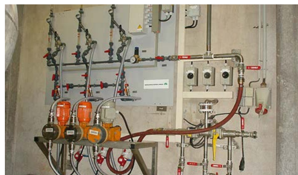
Abbildung | Entschäumer Dosieranlage
